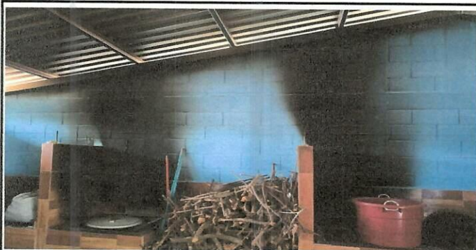
Foto 3: CHIMENEA TIPO CAMPANA
